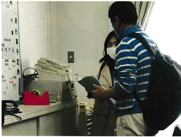
【非常時のWi-Fi】校長室と体育館に設置された機器で、最大90人がインターネットに接続できます。
